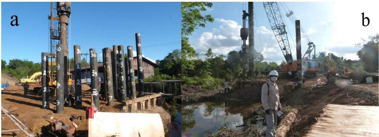
Gambar 1. Tiang Pancang Pipa Baja (a) Sisi Jengan Danum. (b) Sisi Kampung Tepulang
