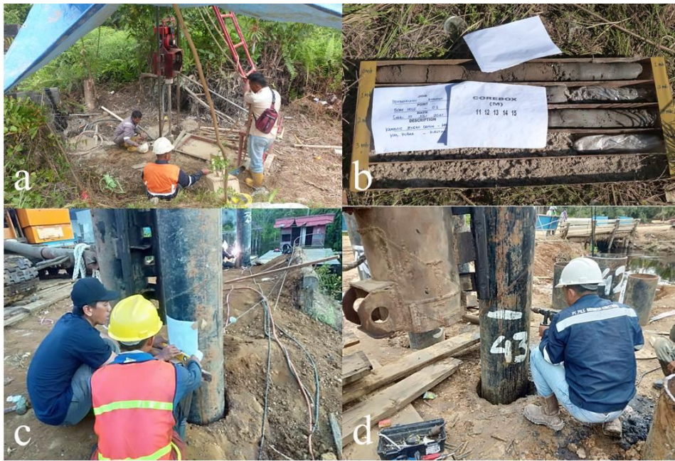
Gambar 3. (a) Uji Borehole , (b) Sampel Tanah Hasil Borehole , (c) Uji Kalendering, (d) PDA Test
